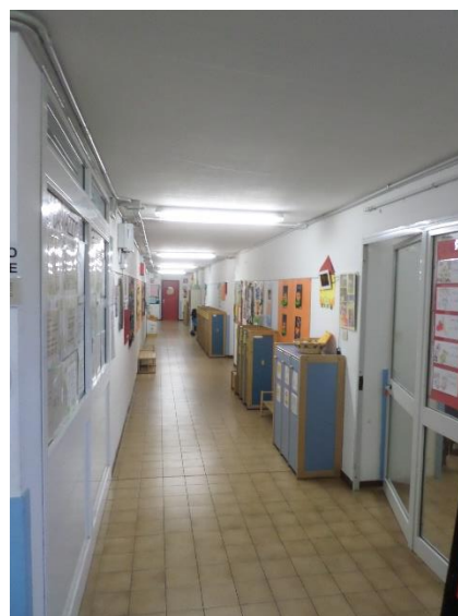
Figura 4.11 - Particolare dei corpi illuminanti ubicati nel corridoio
