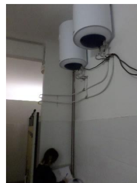
Figura 4.10 - Particolare di un boiler elettrico per la produzione di acqua calda sanitaria
