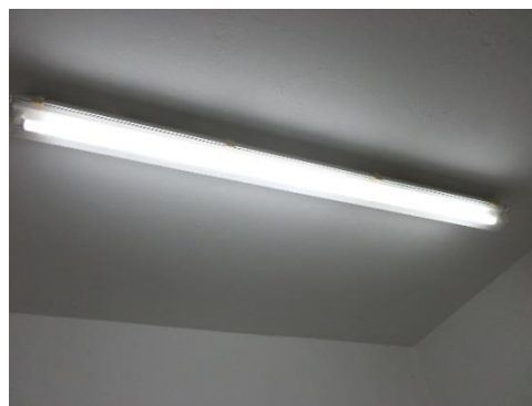
Figura 4.12 - Particolare dei corpi illuminanti
