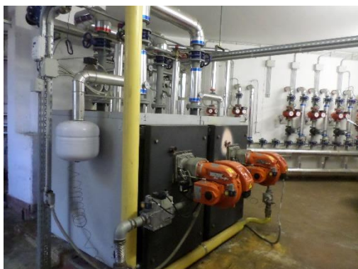
Figura 4.9 - Particolare del generatore a combustione
